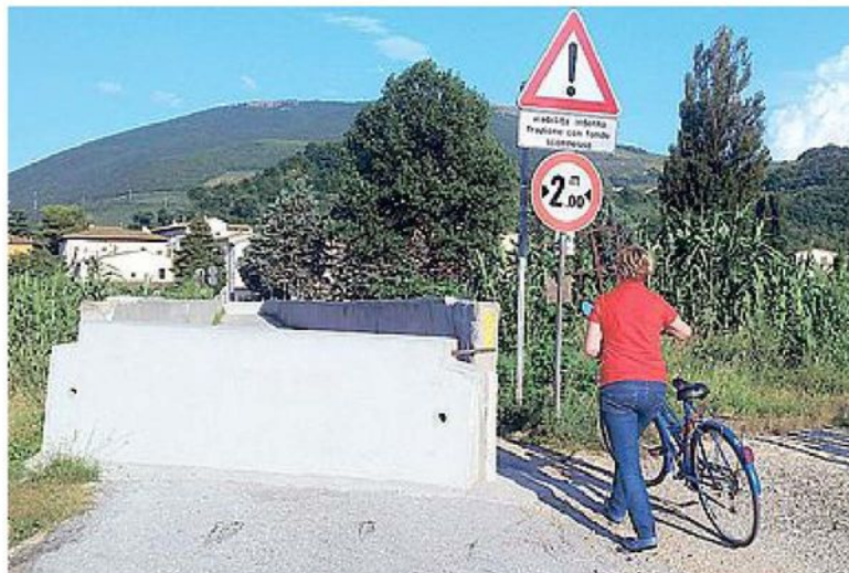
LE CAUSE Le piogge hanno determinato un cedimento strutturale
